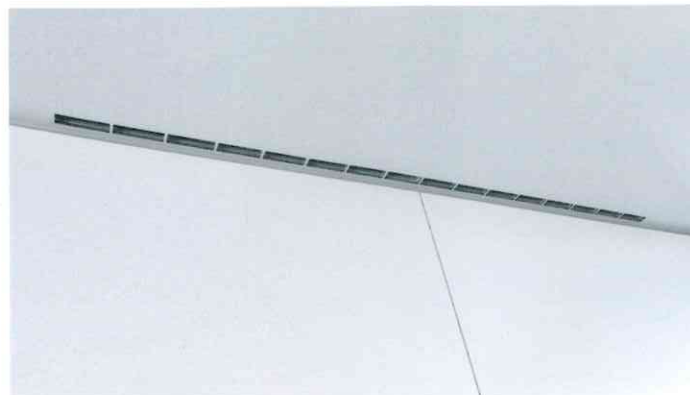
/ Sorgt für frische Luft im Kubus: Die Be- und Entlüftung übernimmt ein autarkes schallgedämmtes Lüftungselement.
