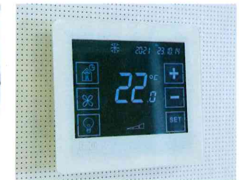
/ Über ein Touch-Display kann der Nutzer Lüftung, Kühlung und Beleuchtung individuell einstellen.
